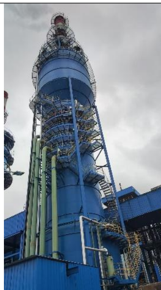
DA005 排气筒及废气处理装置
