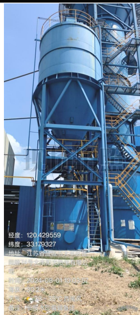
DA002 排气筒（石灰石粉仓）及废气处理装置
