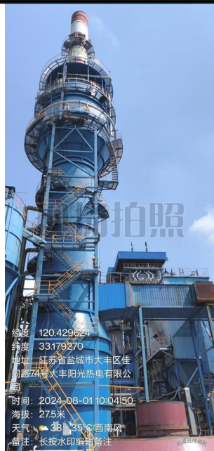
DA001 排气筒及废气处理装置
