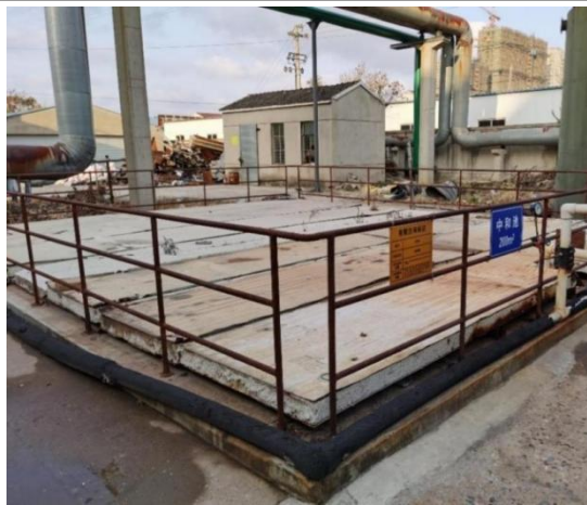
化水车间废水中和预处理池
