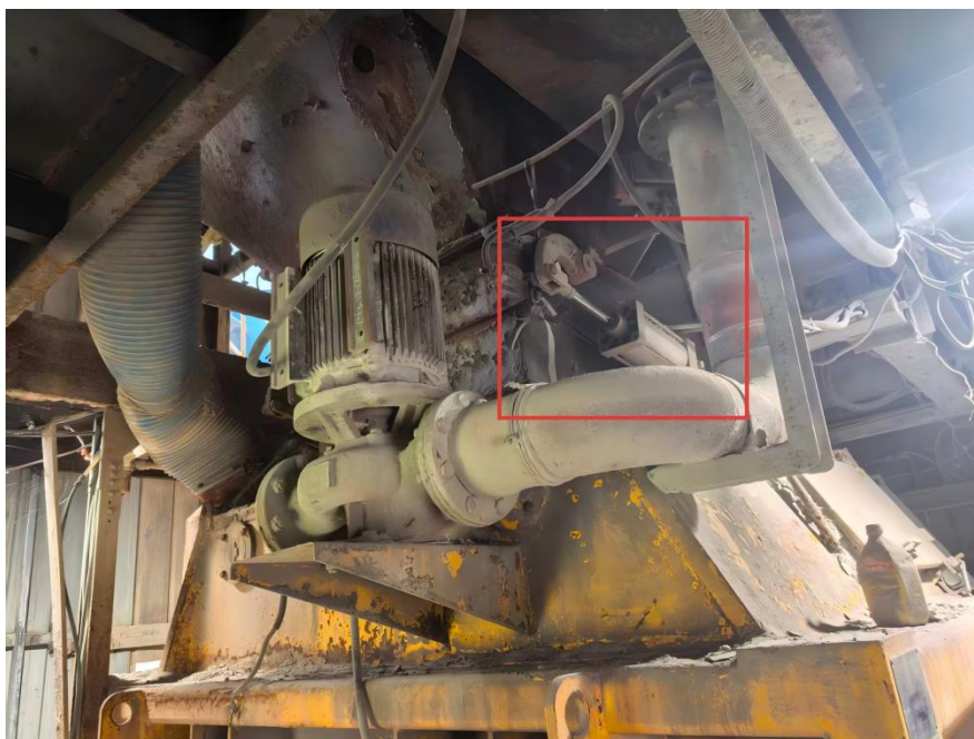
图 3 1#搅拌机中途仓门控制气动连杆
